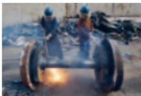
Der grösste Teil der 120-Tonnen-Lok wird nach der Demontage eingeschmolzen und recycelt.
